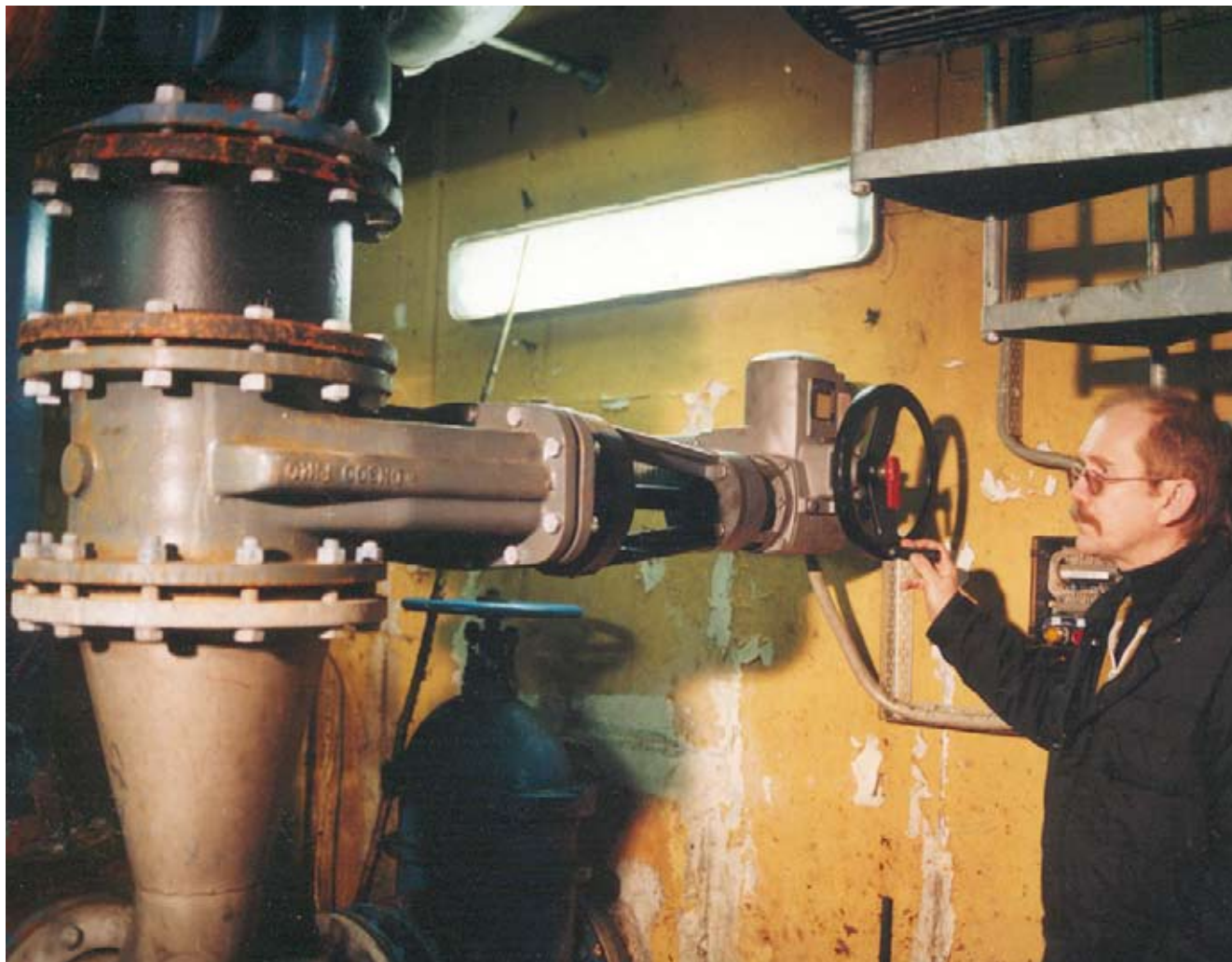
Die Modernisierung der Kräne des Pumpspeicher-Kraftwerks Bleiloch führte zu reduziertem Wartungsaufwand und erhöhter Benutzerfreundlichkeit. Zwei Brückenkranе des Maschinenhauses können mechanisch mit einem Portalkran auf dem Vorplatz für Drosselklappen verbunden werden. Dies macht den Transport von Lasten bis zu 100 Tonnen möglich.
